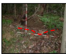
② 切土のり面上部のクラック(h=0.3m)
