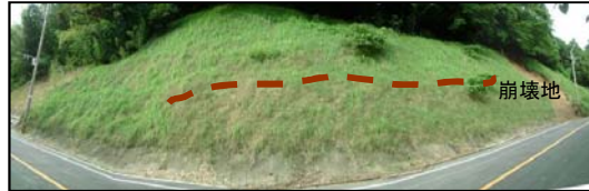
③ 斜面中腹のはらみ出し
