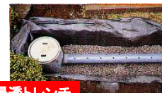
浸透トレンチ
