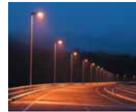
道路照明(高圧ナトリウム灯)
