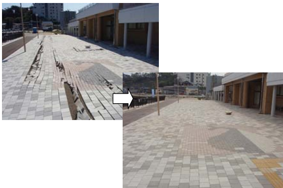
新潟県中越沖地震(公園施設)
