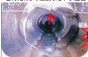
老朽化により破損した下水道管
