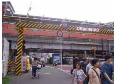
現在の状況(対策実施中)
