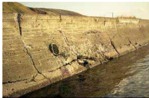
堤防の表法被覆工が損傷
