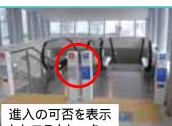
進入の可否を表示したエスカレーター
