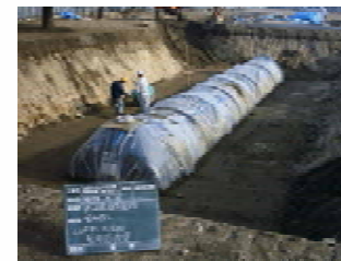
耐震性貯水槽
