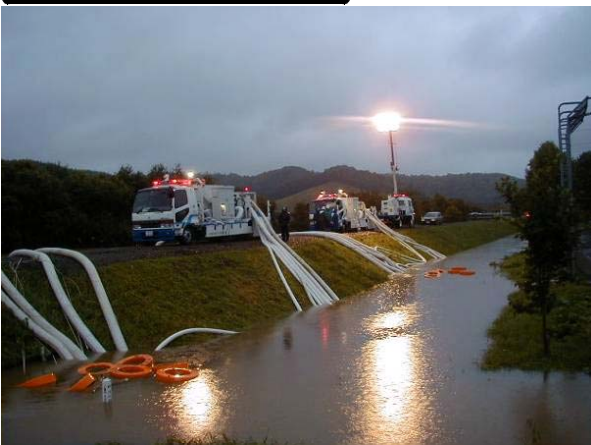
災害時の排水状況
