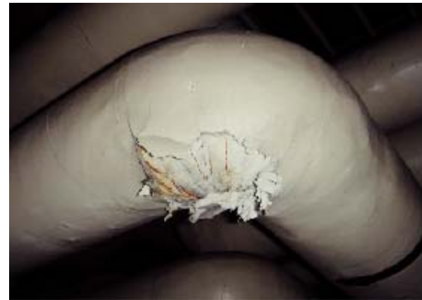
配管エル ボの保温 材①
