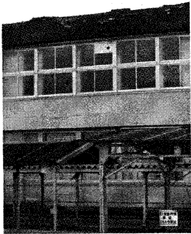
写真 5. 15. 3 旧校舎の棟瓦落下
