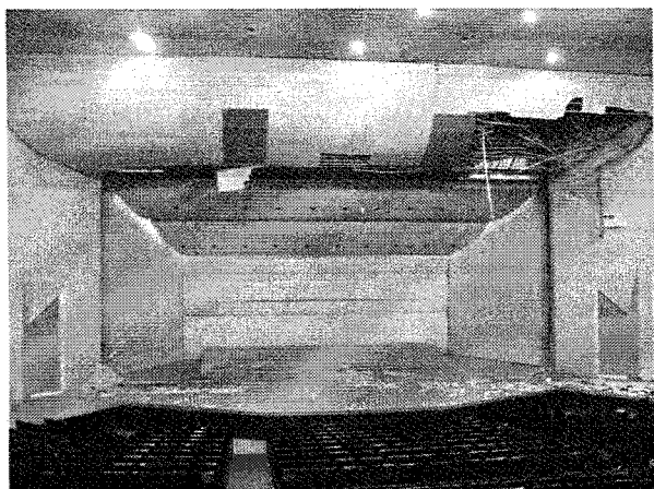
図 10 公会堂舞台上の内装仕上材の被害（赤色）
