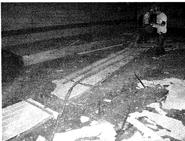
図 11 脱落した内装仕上材（同左）
