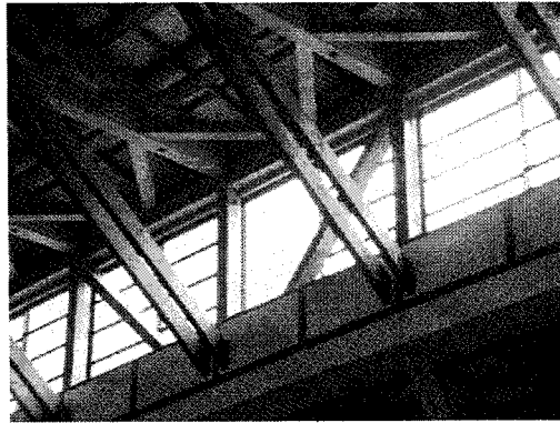
写真5.5.2 同、高窓サッシ脱落部の内部小屋組
