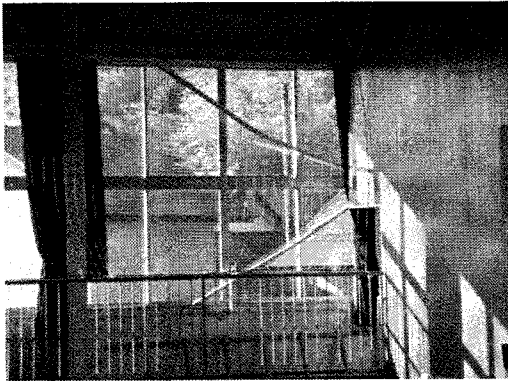
写真5.11.7 ブレース座屈（内部より）
