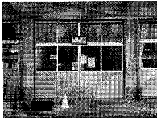
写真5.11.3 旧校舎1階出入口脇の柱の損傷
