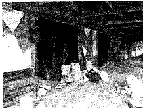
写真5. 6. 5 同住宅牛小屋の土壁剥落
