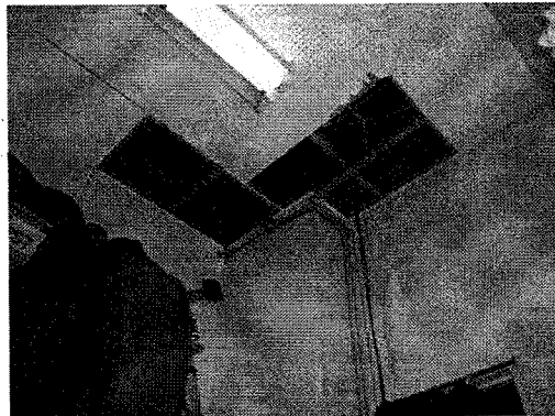
写真5.7.5 ステージ脇2階天井板の落下
