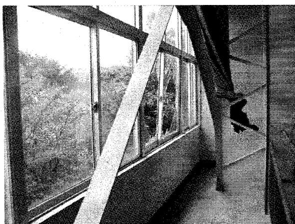
図3 同左のブレースの座屈（同左）
