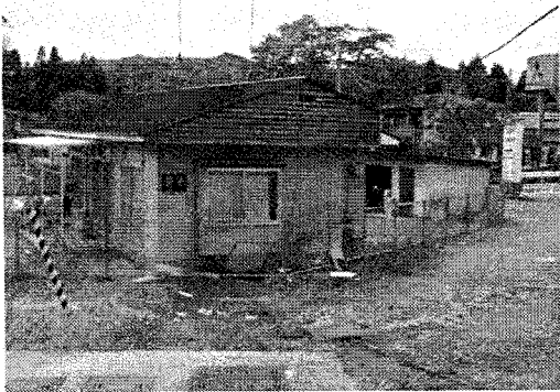
写真5. 6. 1 妻壁仕上げ剥落（栗駒松倉）
