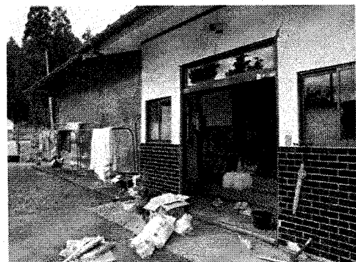
写真5. 6. 4 外壁損傷及びサッシの脱落
