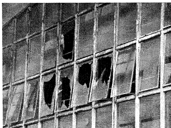
図4 公共体育館の突出し窓の被害（水色）
