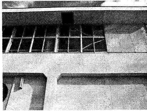
写真5.11.6 軒天落下及びブレース座屈
