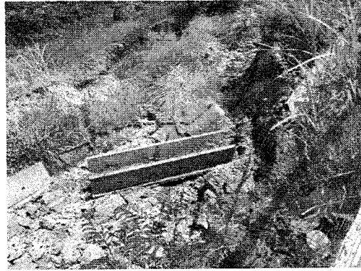
写真5.2.4 校庭南側の法面崩壊
