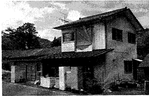
写真5. 6. 3 住宅の窓の損傷
