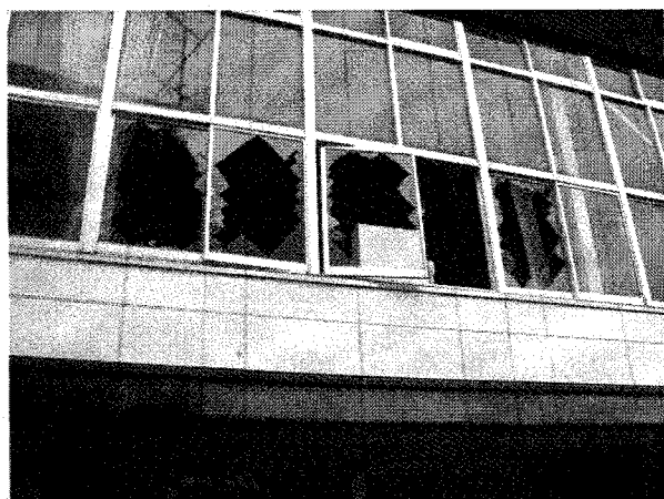
図2 学校体育館の窓ガラスの被害（桃色）
