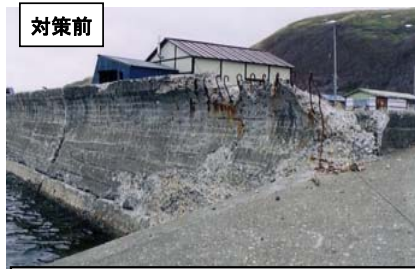
コンクリートの劣化等老朽化が進んだ護岸
