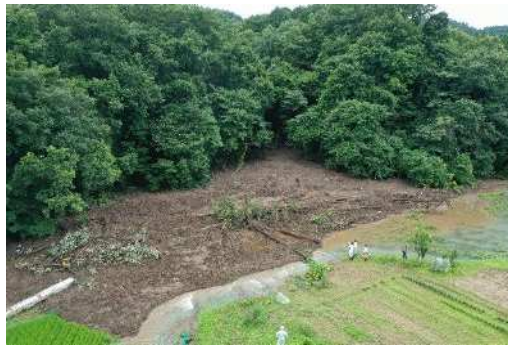
崩落後の土砂流出状況
