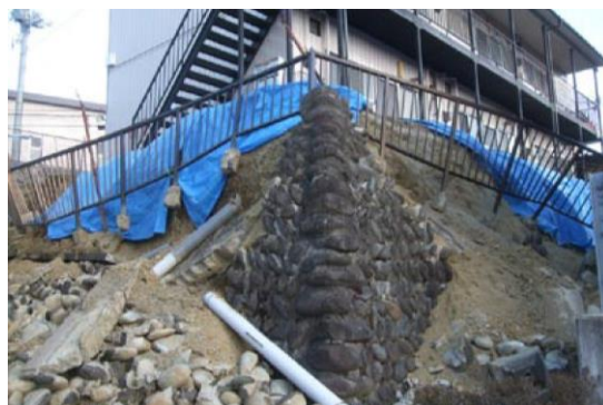
図-1 玉石積擁壁の隅角部の崩壊（宮城県）
