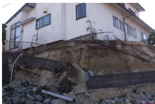
図-3 玉石積擁壁の崩壊（宮城県）
