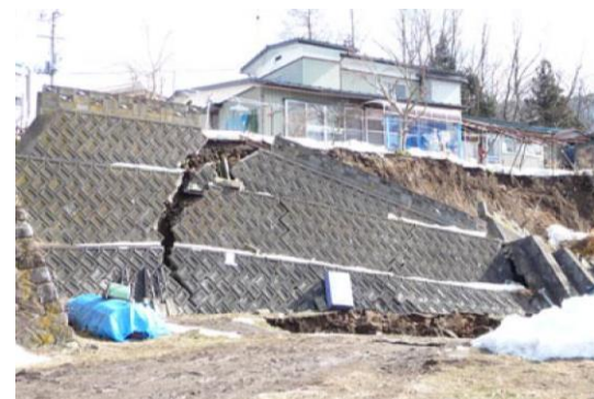
図-2 宅地盛土擁壁の崩壊（青森県）
