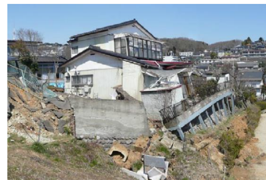
図-4 宅地地盤の変形に伴う擁壁の崩壊（宮城県）
