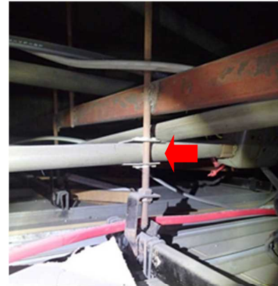
天井吊りボルトに設備配管が共吊り
