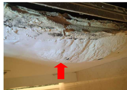
漏水による天井材の劣化
