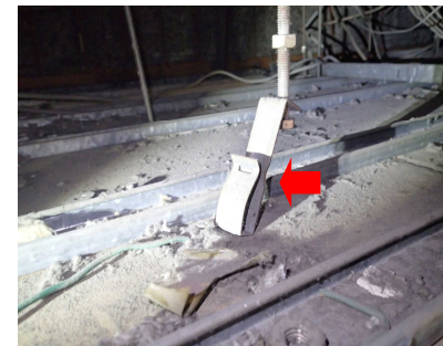
ハンガーの脱落
