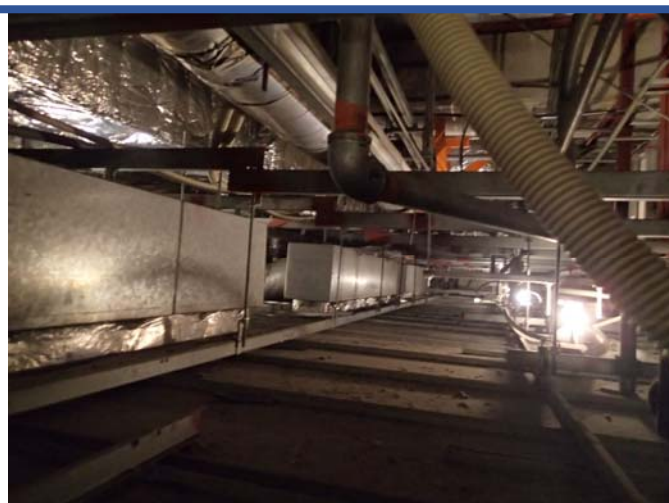
ダクト等が整然と吊られた事例
