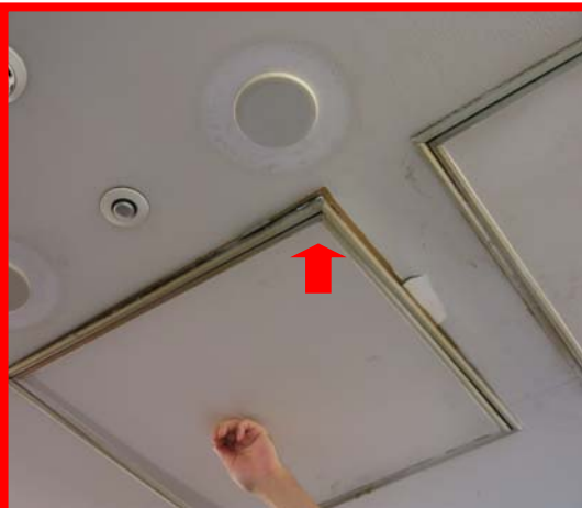
点検口枠に隙間
