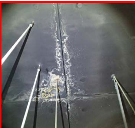
構造物面の漏水跡
