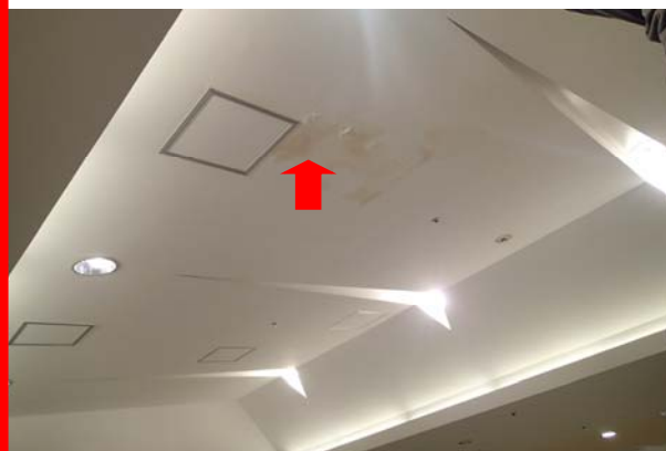
点検口周りのボードに漏水跡
