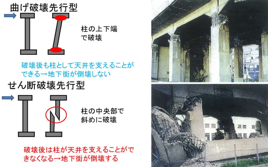
図 3-3-1 高架橋での破壊モードと被害の状況
