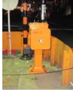
更新された踏切保安設備
