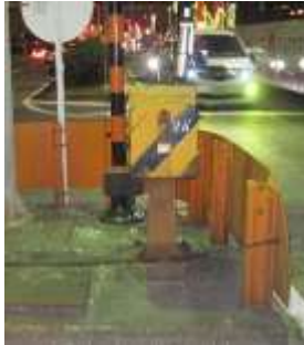
老朽化した踏切保安設備
