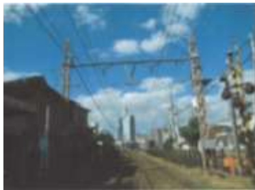
老朽化した電車線
