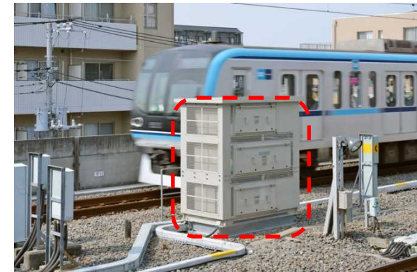
駅補助電源装置
