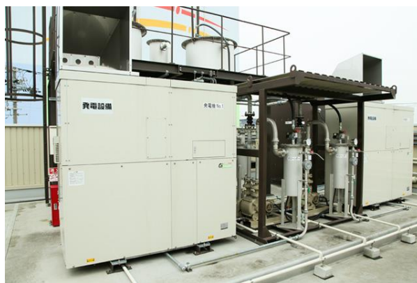
バイオガスコージェネシステム (ヤンマーエネルギーシステム(株)HP より)
