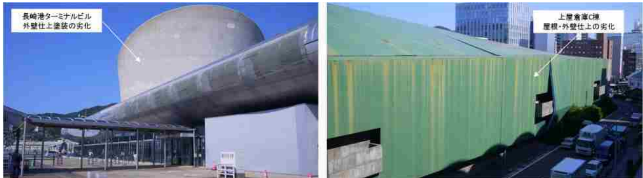
図 4.6. 既存建物の劣化状況
