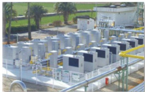
バイオガス発電施設
