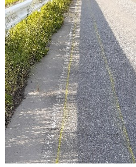
区画線の摩耗
