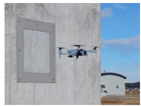
ドローンによる損傷把握
