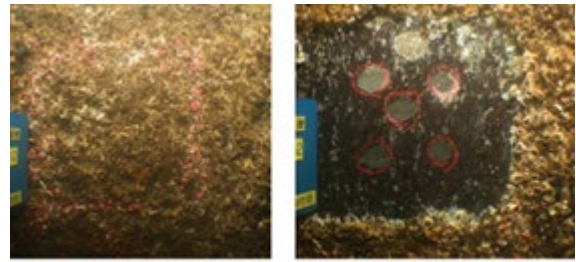
ケレン前 ケレン後 図 3.1-20 ケレン前後の鋼矢板の表面状態
