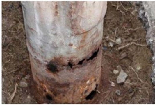
図 1.2-1 照明柱の地際腐食の一例
