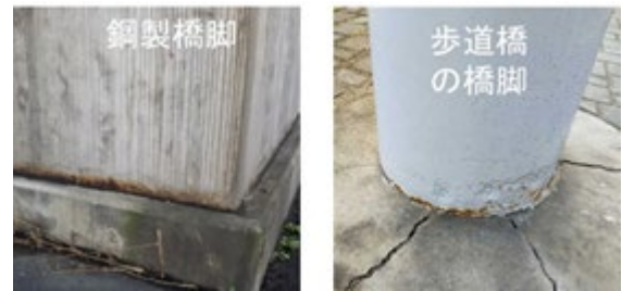
図 1.2-2 鋼製橋脚の地際腐食の一例
