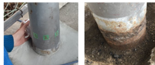
(a) ELECTによる計測と地際下の腐食状況
