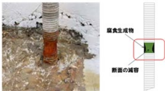
図 1.3-1 アンカーボルトの腐食例 1) (道路附属物)
