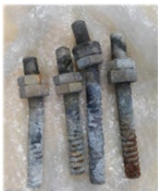
図 1.3-2 アンカーボルトの腐食例 (鉄道附属物)
