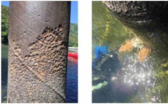
図 3.1-19 パイルベント橋脚の腐食例と検査風景
