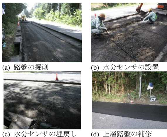
写真 4.28 水分センサの設置状況（福岡坂下線）
