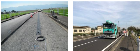
(a) 光ファイバーセンサの敷設状況 (b) 大型車両の走行試験
