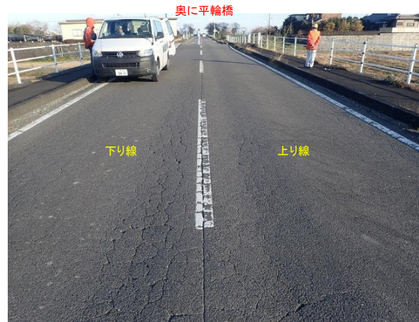
写真4.2 試験施工前の路面状況 (写真奥平輪橋)
