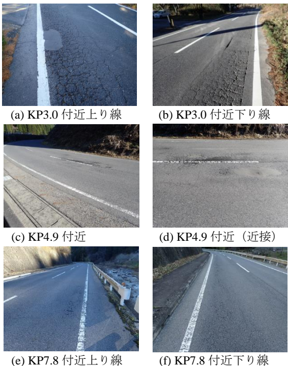
写真 4.7 修繕工事前の路面状況(福岡坂下線)
