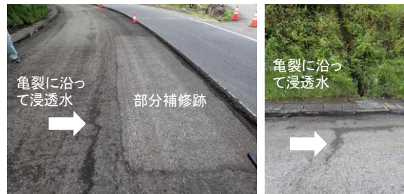
写真 4.9 切削した路盤からの浸透水の様子（KP4.96 付近）
