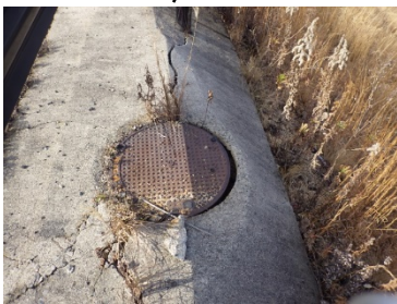
法肩クラック 開口幅 20mm 程度
