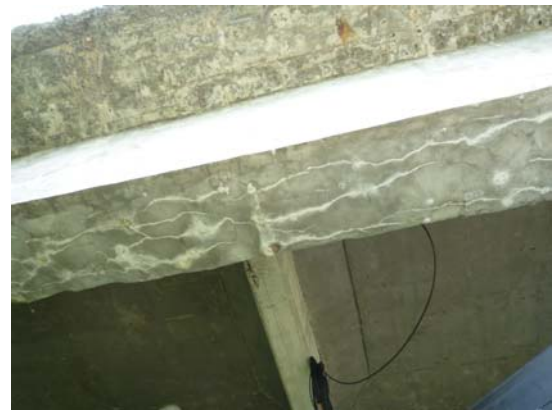
(a) A桁下面(軸方向ひび割れあり)
