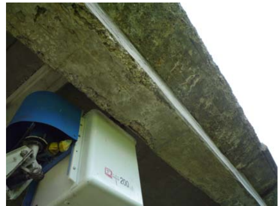
(b) B桁下面(軸方向ひび割れなし)
