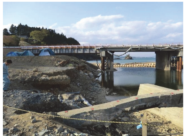
写真-5.1 二十一浜橋の被災状況
