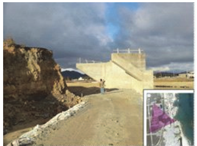
写真-5.2 相馬郡新地町付近の橋桁流出
