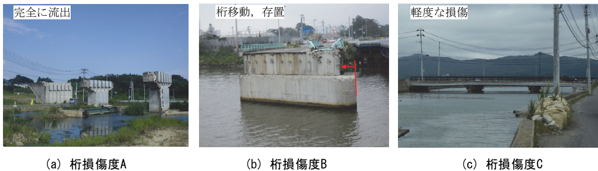
図-2.3 桁損傷度の代表例
