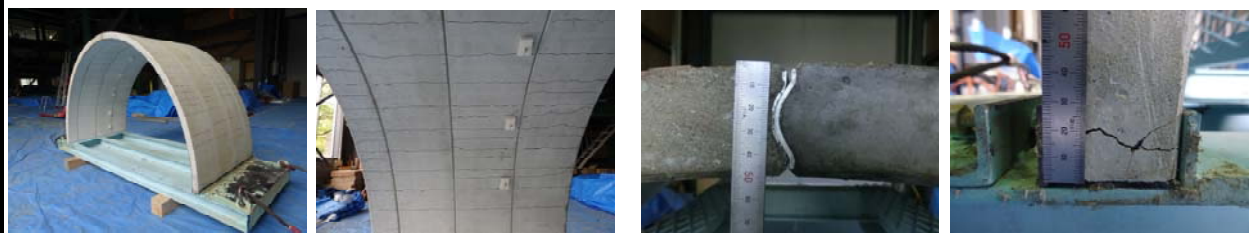
写真-2 加振後のひび割れの状況
