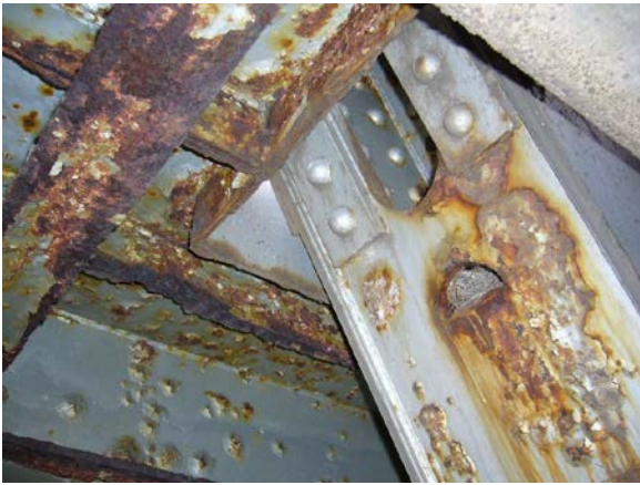
図 3-10 供用 40 年の鋼橋腐食（さび）状態 外観調査。著しい腐食箇所では、腐食孔が 発生している場合もある。
