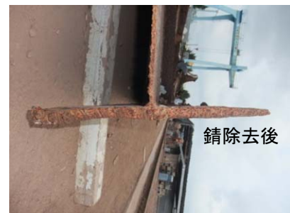
写真 2-9 下フランジの腐食状況
