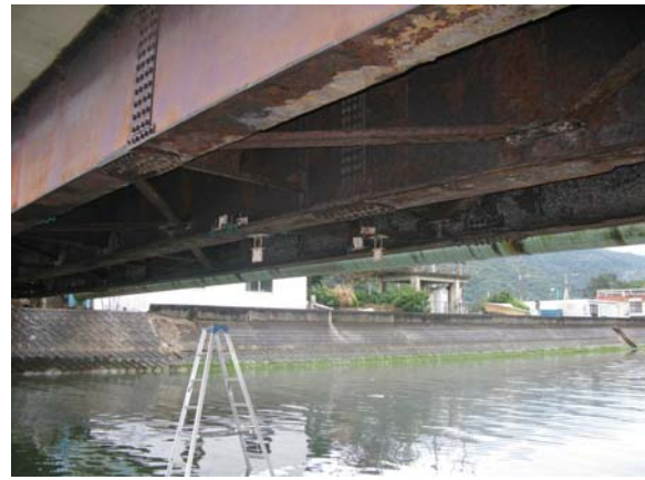
<暴露橋の内桁の腐食>
