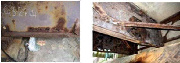
a) 護岸構造物の直上(外桁) b) 護岸構造物の直上(中桁) 図2-8 桁端部の腐食破断状況
