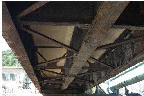
<桁下からの腐食状況>
