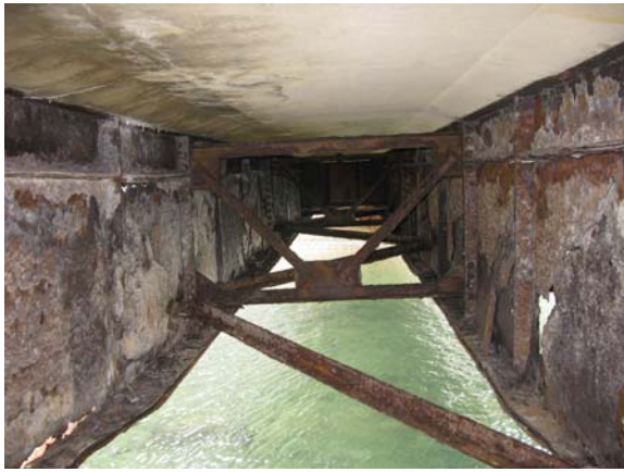
<暴露橋の外桁の腐食>
