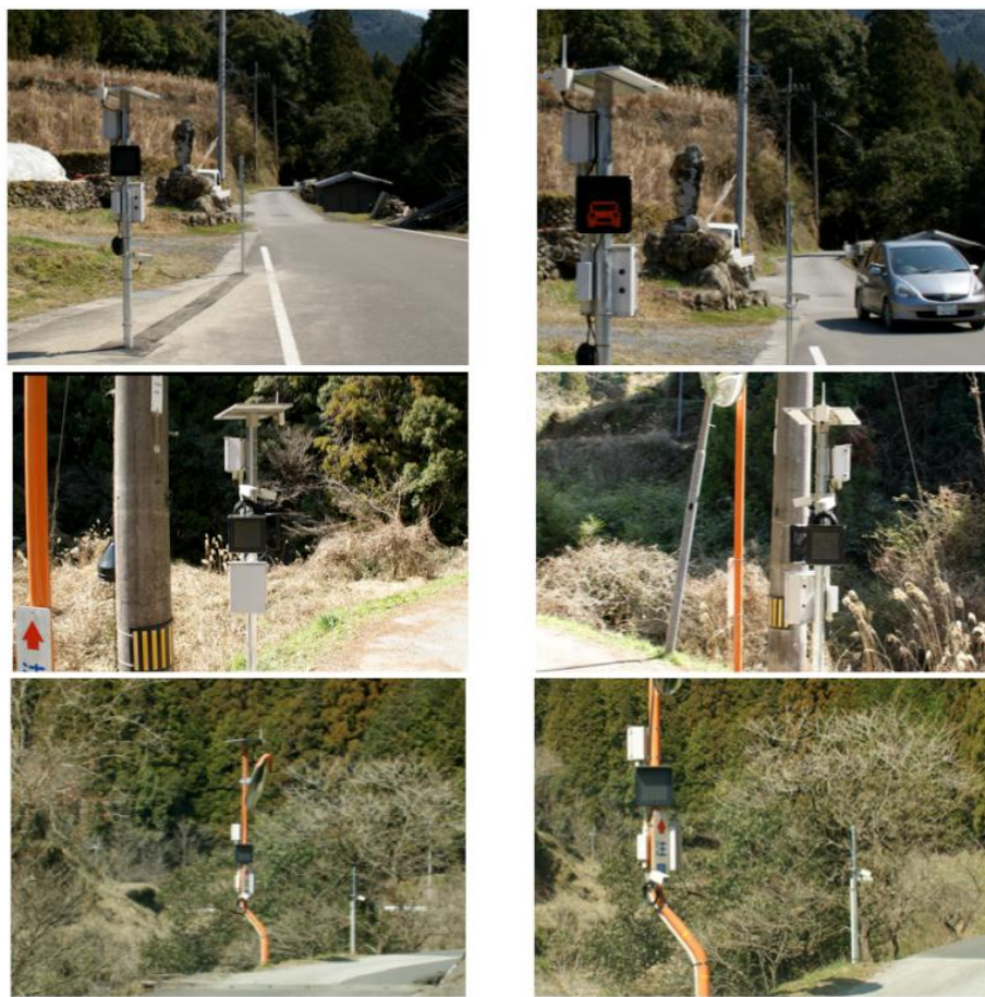
図-60 ゆずりあいロード支援システムの導入状況
