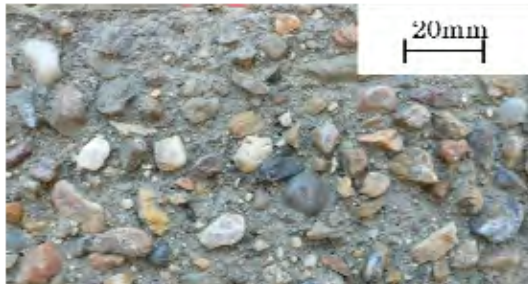
写真-3.2 洗出し後に露出した粗骨材
