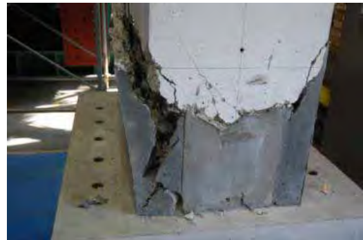
写真-5.11 UHP-SHCC 補修供試体の損傷状況 (拡大図)
