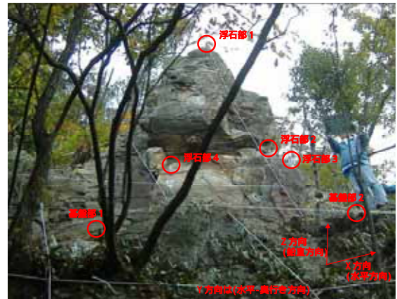
図3.9 自然林内の亀裂性岩塊の不安定部分の一例
