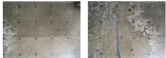
(a) 計測エリアA (b) 計測エリアB 写真-3.7 床版No. 3の床版底面の劣化状況
