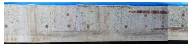
写真-3.3 床版 No. 2の切断面
