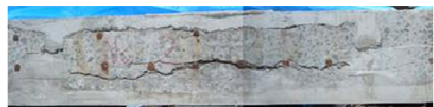
写真-3.2 床版 No. 1の切断面
