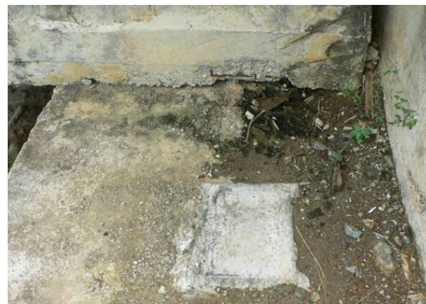
写真-2.1 桁面と橋台間の代表的損傷
