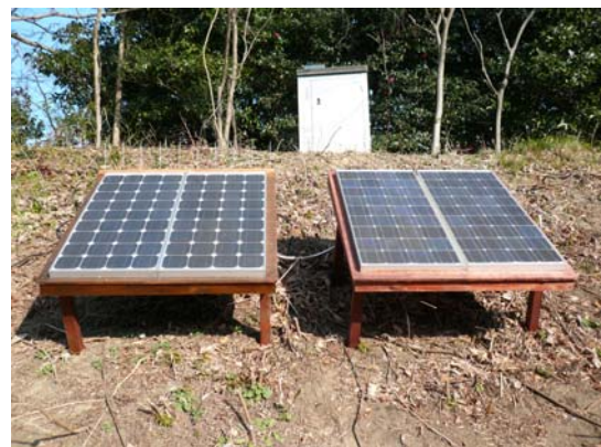
写真-5.8 太陽光発電装置
