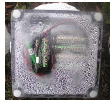
写真-2.6 防水BOXの結露
