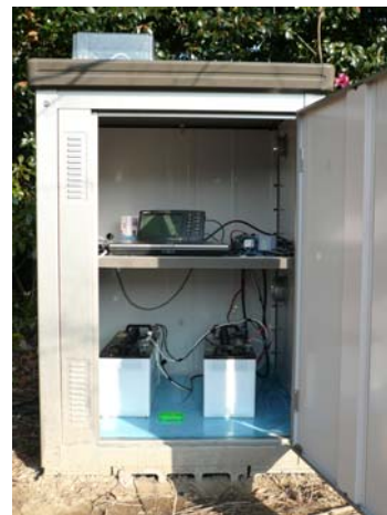
写真-5.4 PCラック (Network M3)
