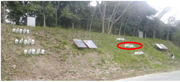
写真-2.5 システムの現地設置状況
