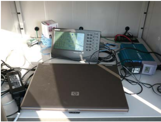
写真-5.6 PCラック内部 (Network M3)
