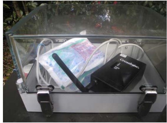
写真-4.9 除湿剤同封状況 (基地局用ノード)
