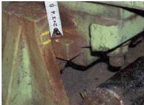
(b) 支承部の損傷状況（ローラーの脱落）
