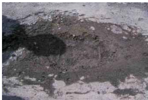
(b) 床版上面の土砂化
