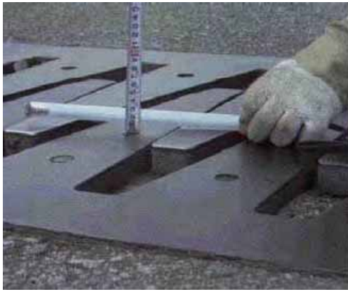
(a) 伸縮部の段差状況
