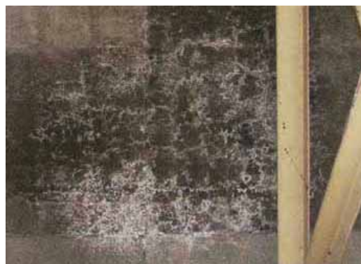
(c) 床版下面のクラックと遊離石灰
