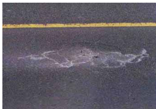
(a) 舗装の損傷
