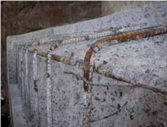
写真 3-27 鉄筋の破断事例 (曲げ加工隅角部で脆性的に破断)
