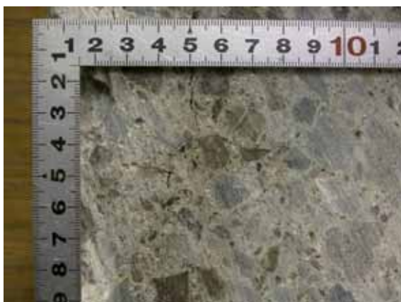
写 3-7 顕著なひび割れ
