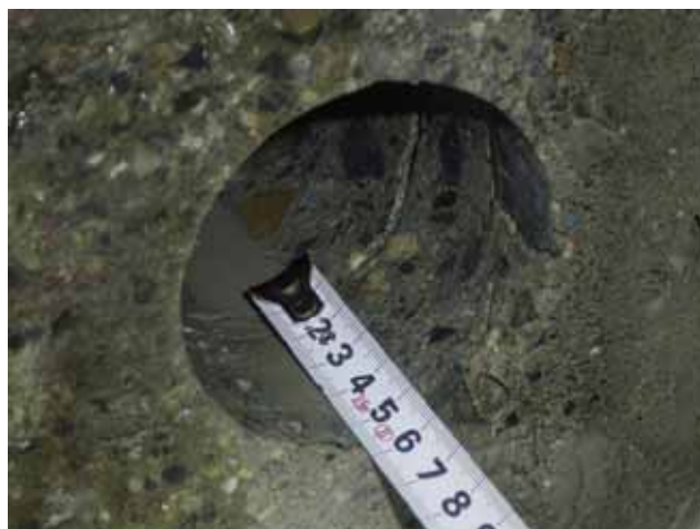
写 3-20 終点側 8m 地点コア穴
