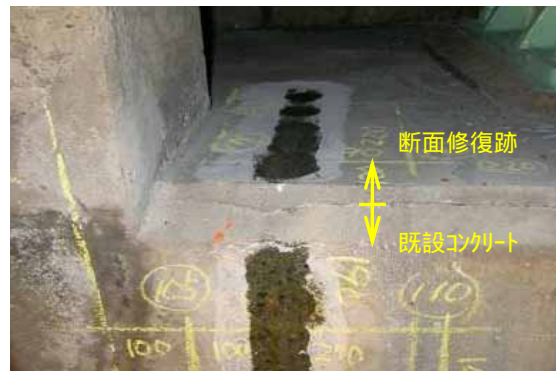
写 3-22 上面の状況(浮き)
