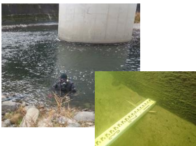
潜水調査による河床洗掘の把握
