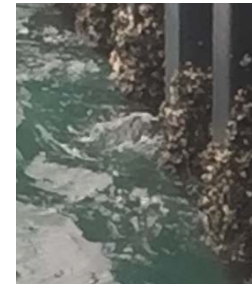
水中付着物下の腐食
