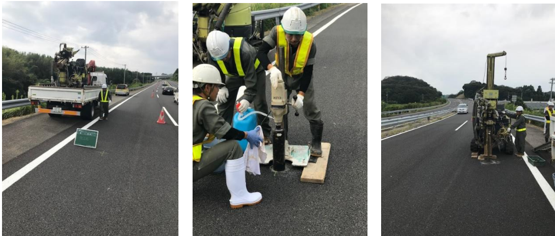
写真-1 左より、調査位置 (外側わだちの内側)、舗装刳貫き、コアボーリング状況
