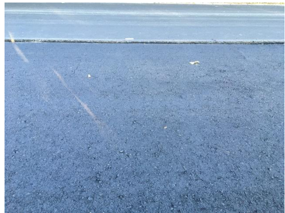
(d) 上層路盤の上面に現れたひび割れ 3
