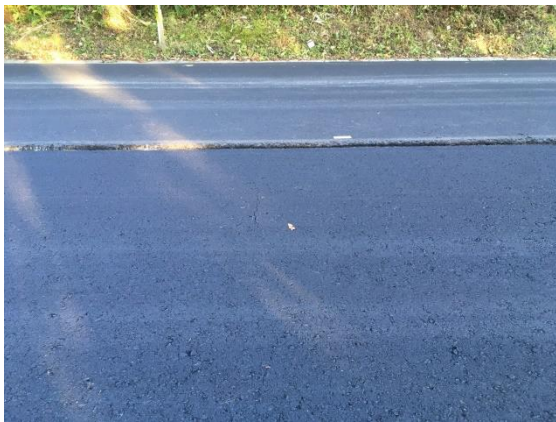
(c) 上層路盤の上面に現れたひび割れ 2
