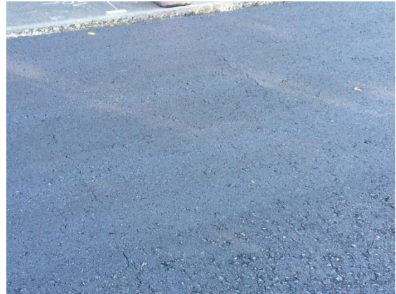
(b) 上層路盤の上面に現れたひび割れ 1
