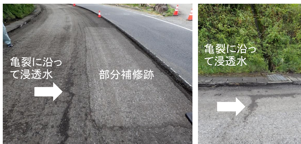
写真-3 切削後の路面状況 (KP4.9 付近、浸透水の様子)
