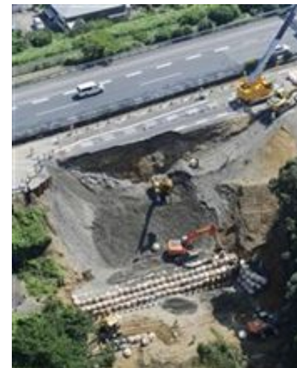
2009年8月11日, 駿河湾地震(M6.5) 静岡県牧之原 東名高速道路のランクD盛土の崩壊
