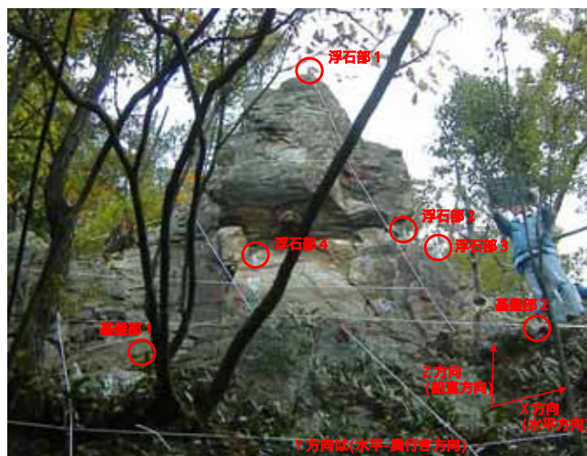
図8 b 自然林内に存在する亀裂性岩塊の不安定部分の一例
