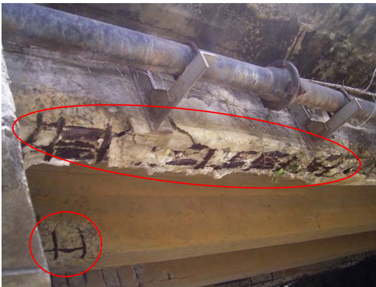
塩害によってコンクリートが剥落し、鉄筋が露出している
