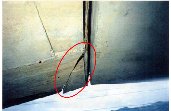
主桁の欠損状況
