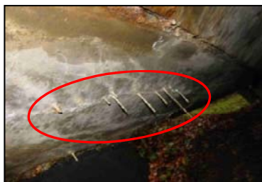
漏水、遊離石灰
