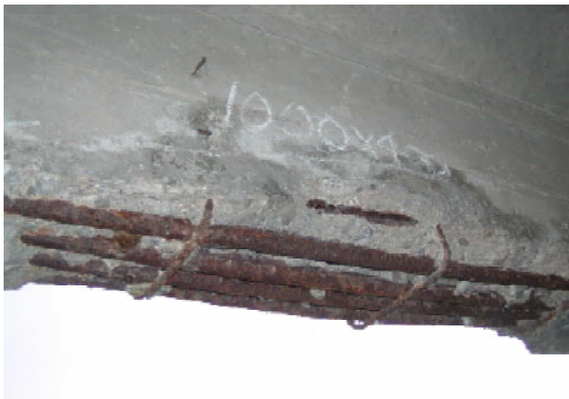
主桁のコンクリート剥離・鉄筋露出
