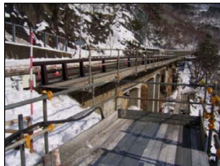
FCB工法による盛土 『冬期施工のため、養生設備 (仮囲い)を設置中』
