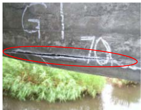
主桁に生じているひびわれ
