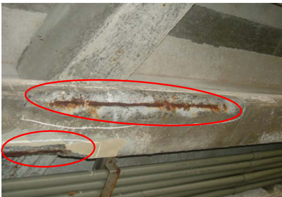
PC鋼線の腐食膨張によってコンクリートが剥落
