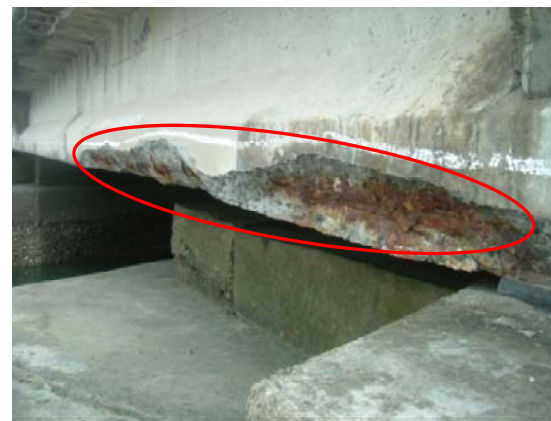
PC鋼線の一部が腐食しコンクリートに断面欠損が生じている(耐荷力の低下が懸念される)
