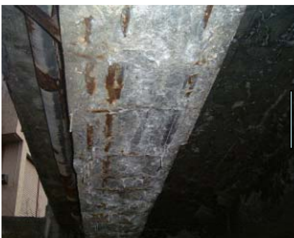
主桁に生じているコンクリートの剥離、鉄筋露出
