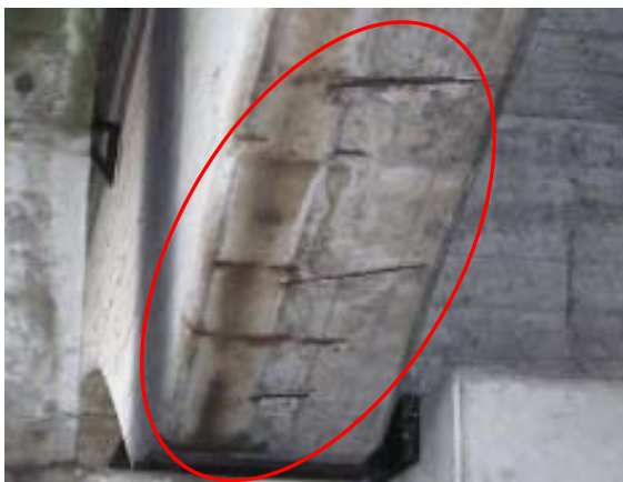
主桁下面の鉄筋が露出している
