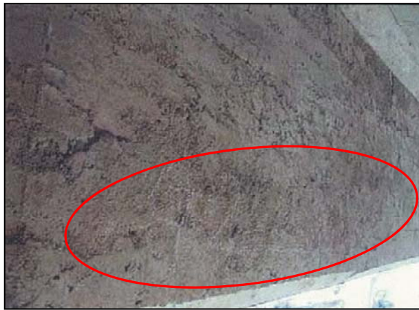
主桁のひびわれ
