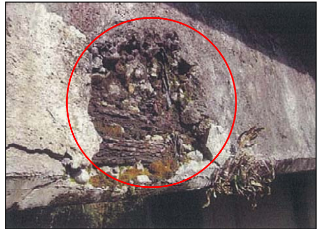
コンクリートの剥離、鉄筋露出・腐食 (耐荷力の低下が懸念される)
