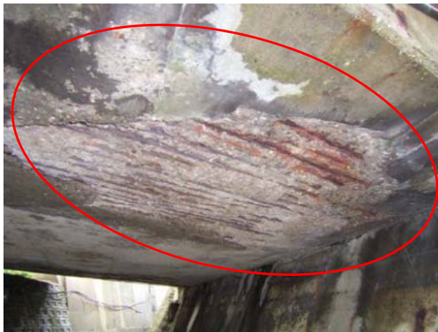
コンクリートの剥離、鉄筋露出が見られる
