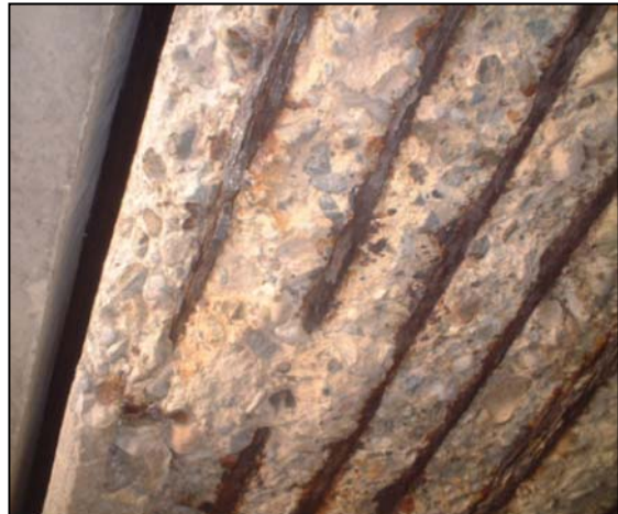
コンクリートが剥落し、腐食した鉄筋が露出している
