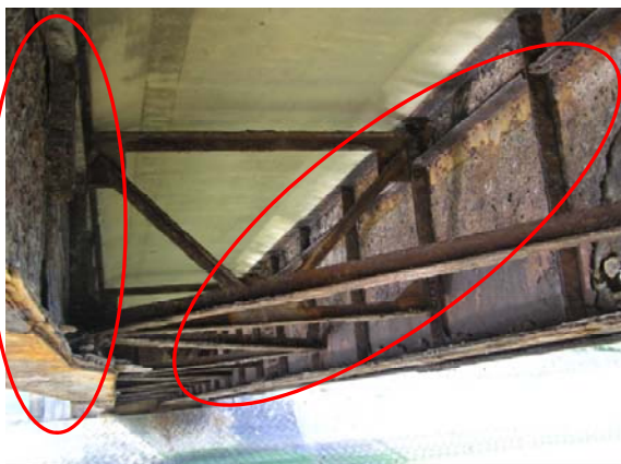
主桁の腐食が進行している
