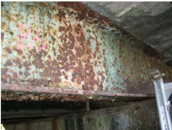
主桁の腐食が進行している
