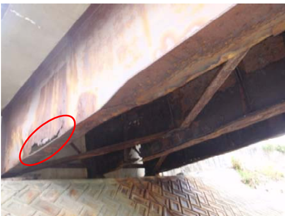
腐食により穴が開いている
