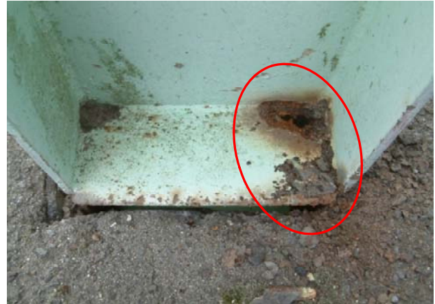
トラス斜材の水がたまりやすい他の部分においても腐食が進行している
