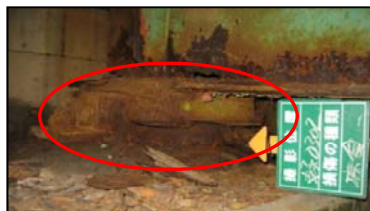
桁を支える支承も腐食している
