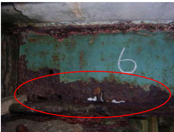
腐食により穴が開いている
