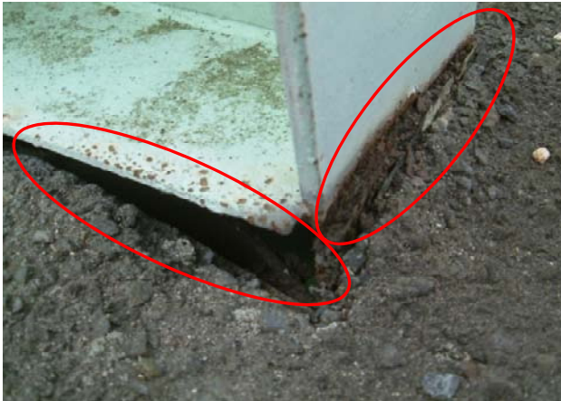
トラス斜材の舗装埋込部において腐食が進行している
