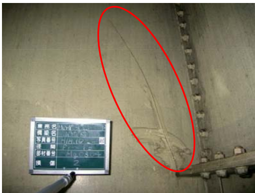
主桁に約1mの亀裂
