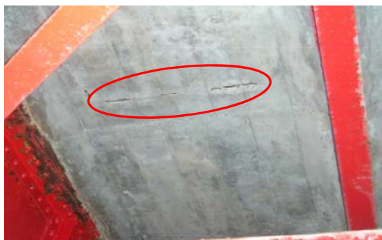
床版にコンクリートの剥離・鉄筋露出が生じている
