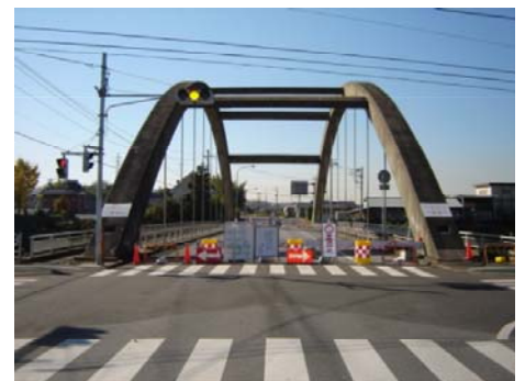
通行止め状況
