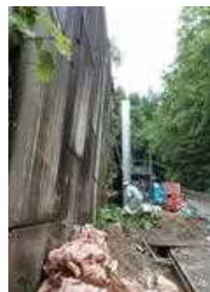
写真 壁面の傾斜の例
