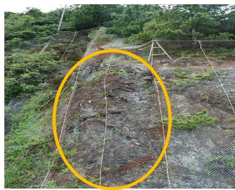
写真 落石防護網の著しい腐食による断面欠損の例
