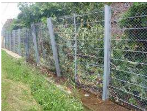
写真 落石防護柵の傾動の例
