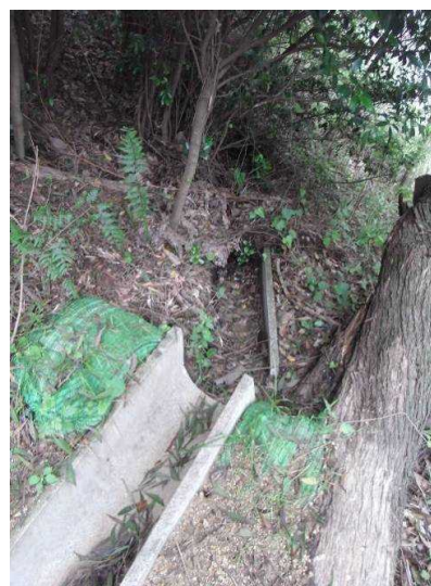
写真 排水溝の破損の例
