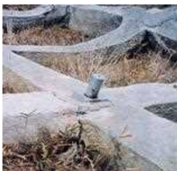
写真 受圧構造物の破損の例
