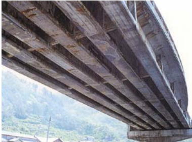
※写真はPC桁下面の損傷事例
