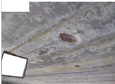
※写真はPC桁下面の損傷事例
