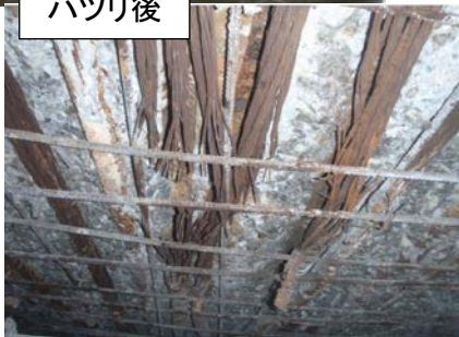
※写真はPC桁下面のひびわれ事例
