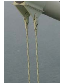
被覆されたハンガーに制震ロープが配置されている例
