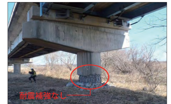
東日本大震災の地震動によって橋脚が損傷 (県道)
