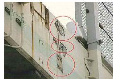
コンクリートの剥落
