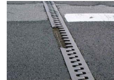
伸縮継手の損傷
