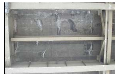
床板のひび割れ
