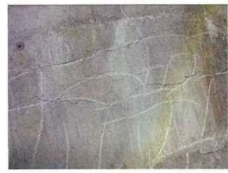
下部工のひび割れ
