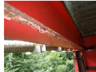
・B判定(腐食)
