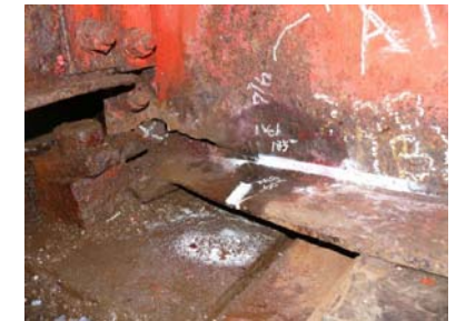
・E判定(腐食・亀裂)
