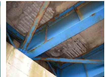
・C判定(剥離・鉄筋露出)
