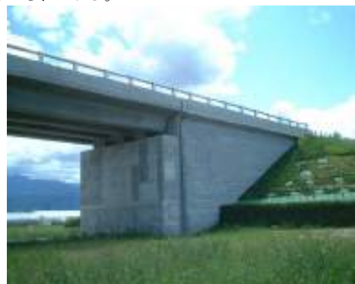
写真 5.3.2 上部工の地覆・高欄がつくるフェイスラインを、10 cmの陰影により橋台、ウィング部にまで連続させることで、水平方向の連続性が確保される。
