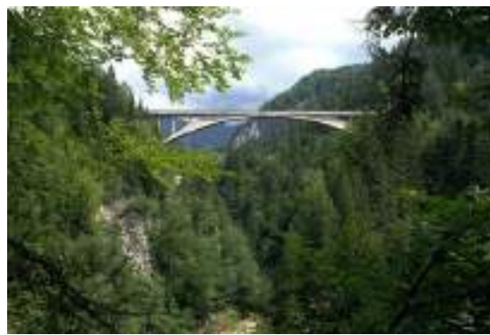
写真 5.3.47 谷地部に似合う上路アーチ橋。深い谷地部に力学的に明快で材料ミニマムの、美しい構造美を表している。1点の橋の美しいフォルムがアクセントとなって、豊かな自然景観を更に印象深く見せる好例。
