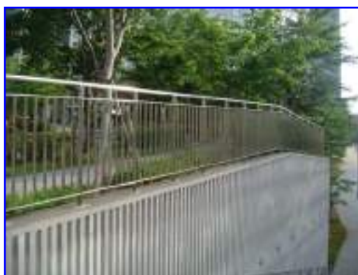
写真 5.2.8 壁面に縦スリットの凹凸を与えることにより、 施工直後の壁面の輝度を軽減するほか、水抜き 穴からの雨だれをコントロールしている
