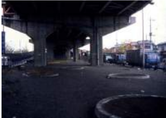
写真 5.3.1213 幅員が広く、桁が低い高架橋の桁下空間は公園整備に適する環境にない。
