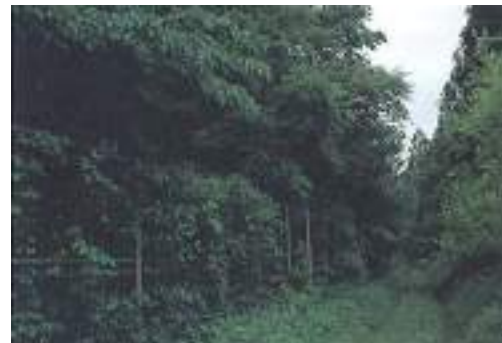
写真5.2.11 写真左側の盛土のり面に貼りつけた表土から、地域の自然植生が見事に回復している。
