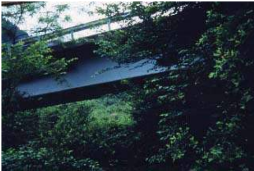
写真 1.17 現在ではすっかり自生した植物によって地域の自然のなかにあるが、けもの道を確保するために、橋台をセットバックしている。
