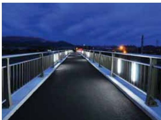
■高欄の縦棧内蔵照明 ポール照明の管理の手間を軽減するとともに、新しい灯りの姿を実現する
