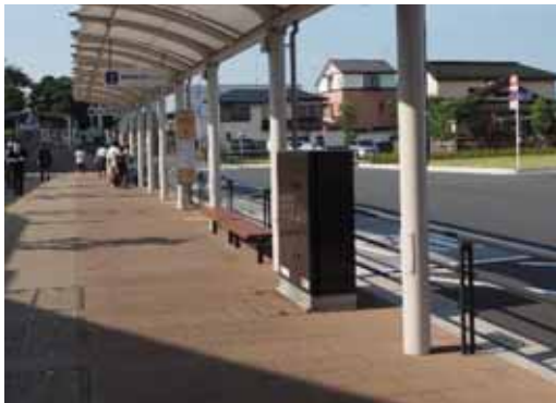
■バス停上屋やベンチ等と合わせて地上機器を設置している例 デッドスペースとなるバス停上屋の柱間に地上機器を配置することで、利用者の動線を邪魔することなくおさめている
