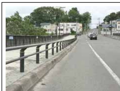
■防護柵の支柱に反射シートを巻き付けることにより、視線誘導を確保している例
