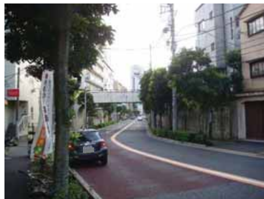
■塗布式のカラー舗装は、定期的な補修が必要である
