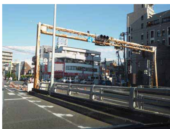
■錆びがかなり目立つ門型標識柱の例 適切な修繕・更新を行っていくことが求められる
