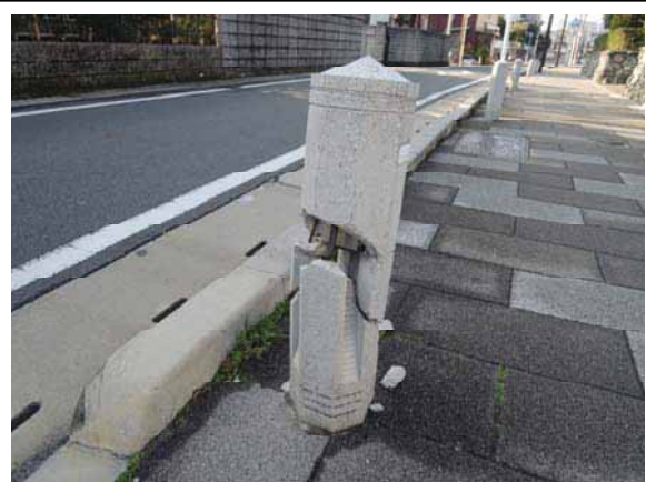
■ 寺町で擬石のボラードを設置した例 沿道出入口の脇にあるボラードは、車両の死角に入り壊される場合が多い
