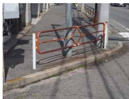
■防護柵全体が錆びつき、見苦しい状態になっている
