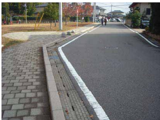
■車道と歩道の分離を目的とする場合は、必ずしも防護柵である必要は無く、縁石やボラードでその機能を担保できる
