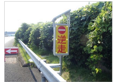
設置事例: 東九州道 大分松岡PA
